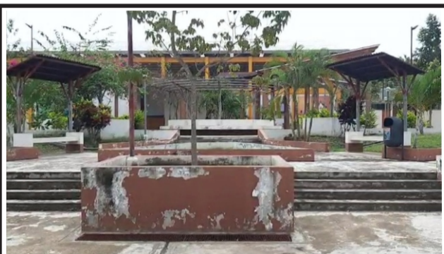
En condiciones pésimas
